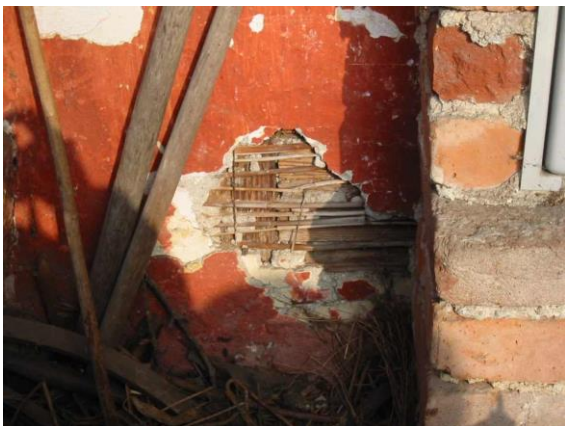
Slika 79: Odpadli omet kaže podlago iz trstičja, na katerega je bil nanesen omet.
