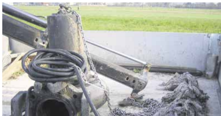
Eno izmed večjih težav v kanalizaciji predstavljajo vlažilni robčki in druge krpice, ki povzročajo zamašitev cevodov in okvaro črpalok.
