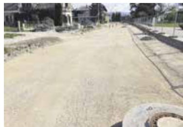
Po končanih delih na vodovodu in kanalizaciji z ureditvijo Ljubljanske ceste nadaljuje Občina Domžale.
